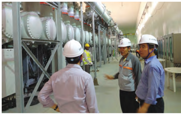
GIS 380KV, 3150A
